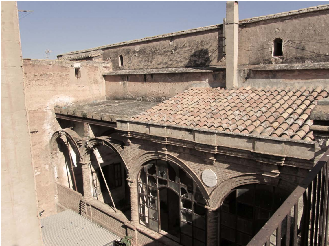
Arcos que forman el segundo nivel del claustro. Obsérvese en la izquierda de la fotografía el apuntalamiento insuficiente con que cuentan los dos últimos tramos. Primeras décadas del siglo XX.
