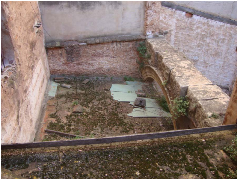
Cubierta del tejadillo de la entrada al claustro, donde el alto contenido de humedad ha provocado la proliferación de vegetación
