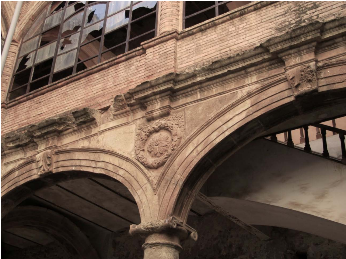
Descenso de las dovelas de los arcos carpaneles del claustro, especialmente en su zona central
