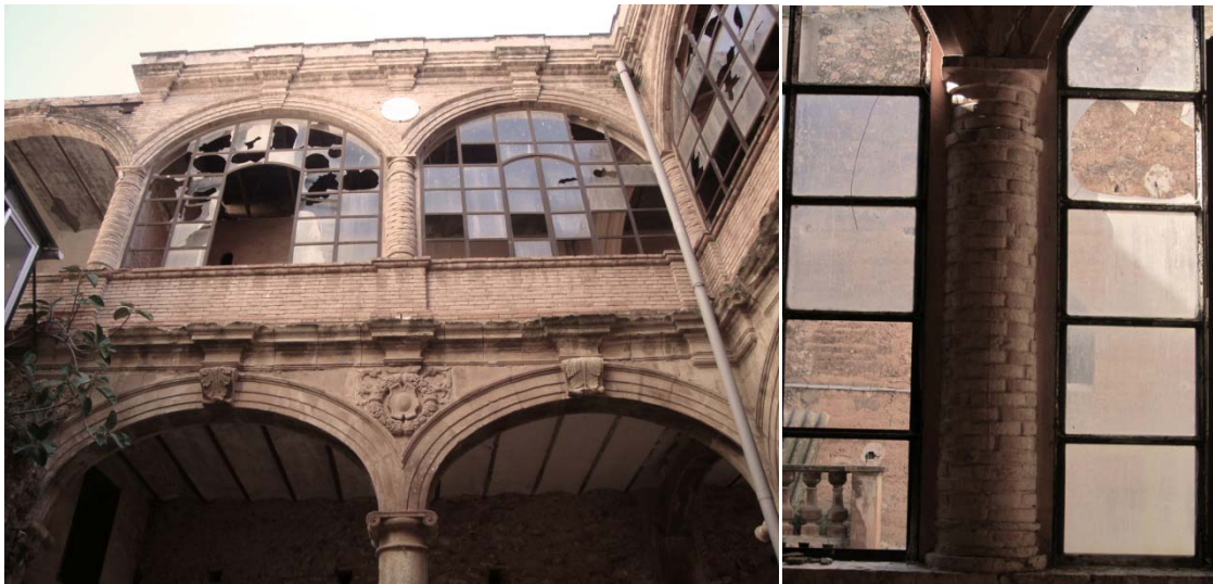
Cristales que amenazan en caer al interior del claustro
