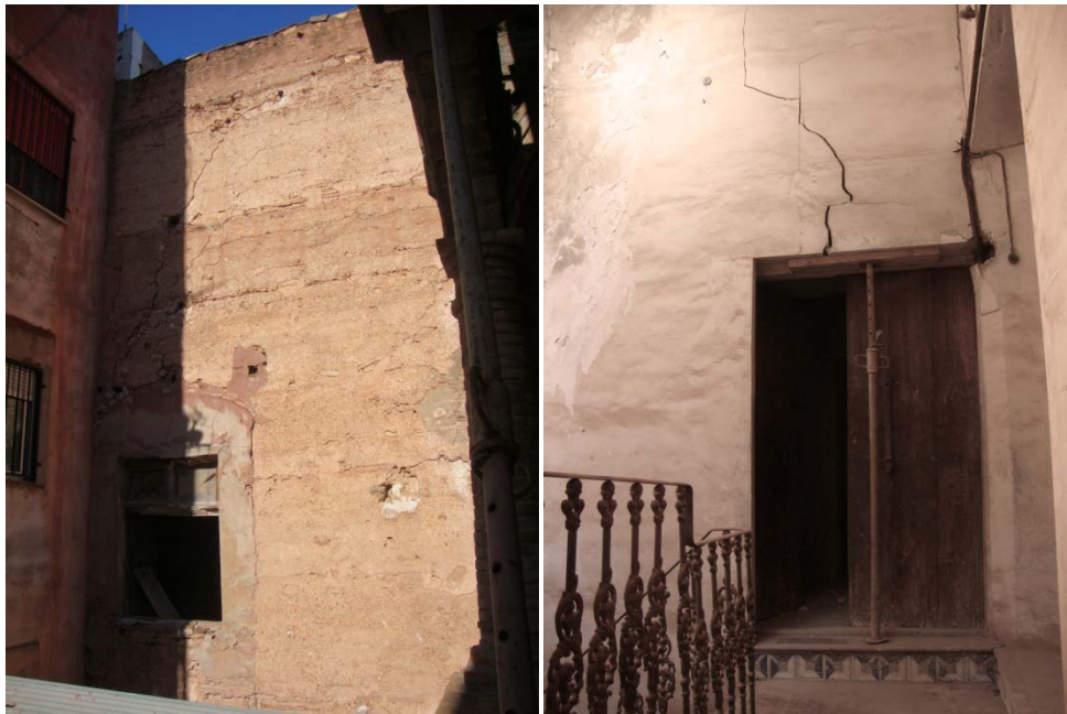
A la izquierda, grieta en forma de arco en el muro de tapia y a la derecha, grieta en forma de arco en uno de los muros de la escalera.
