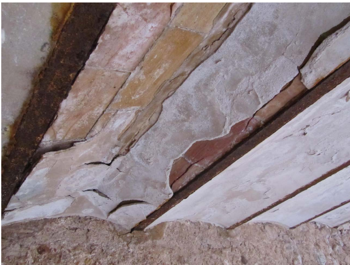
Estado de corrosión del forjado de la panda del claustro que se encuentra en la esquina noreste
