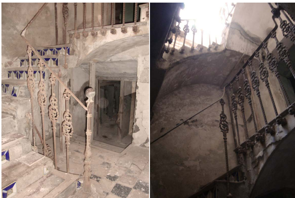
Escalera de bóveda tabicada en avanzado estado de deterioro. Finales del siglo XIX / Principios del siglo XX.
