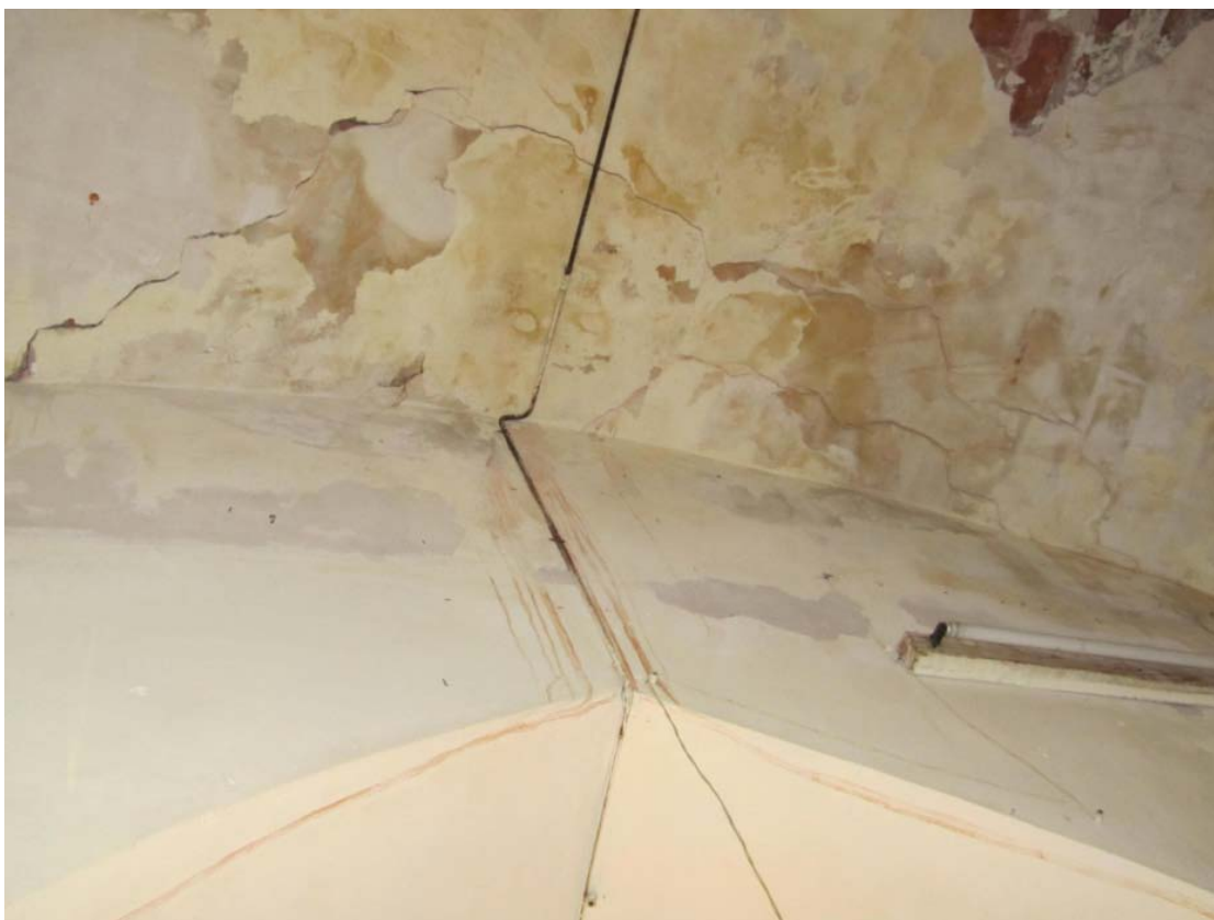
Agrietamiento en el encuentro entre la bóveda tabicada y el arco apuntado en la entrada al palacio
