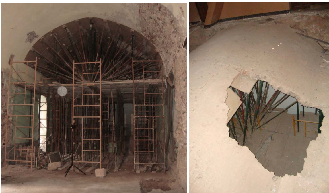
Apuntalamiento "provisional" de la bóveda a rosca que cubre la nave longitudinal del ala este
