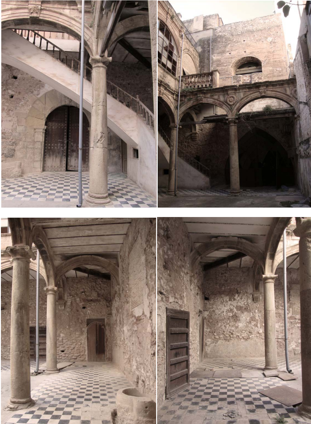
Varios puntos de vista donde se observa el desplome de las columnas
