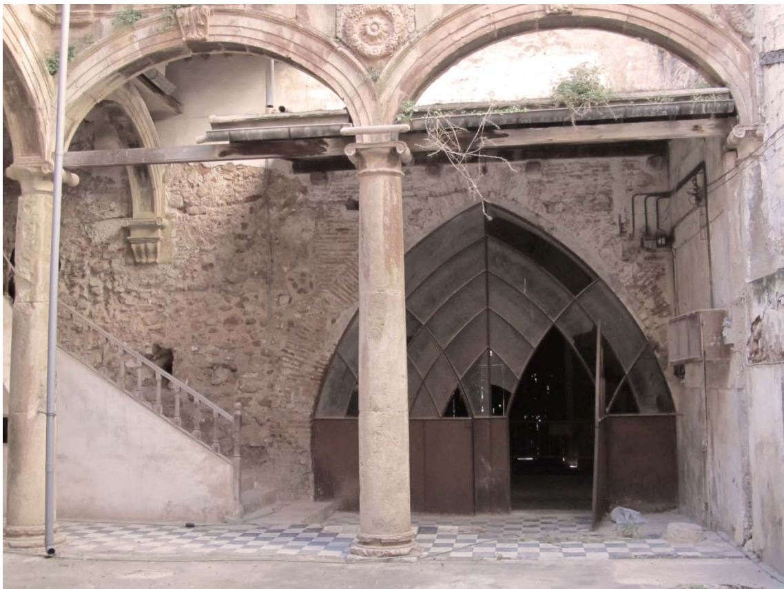
Forjado entabicado de rasilla, con vigas y viguetas de madera y entrevigado cerámico
