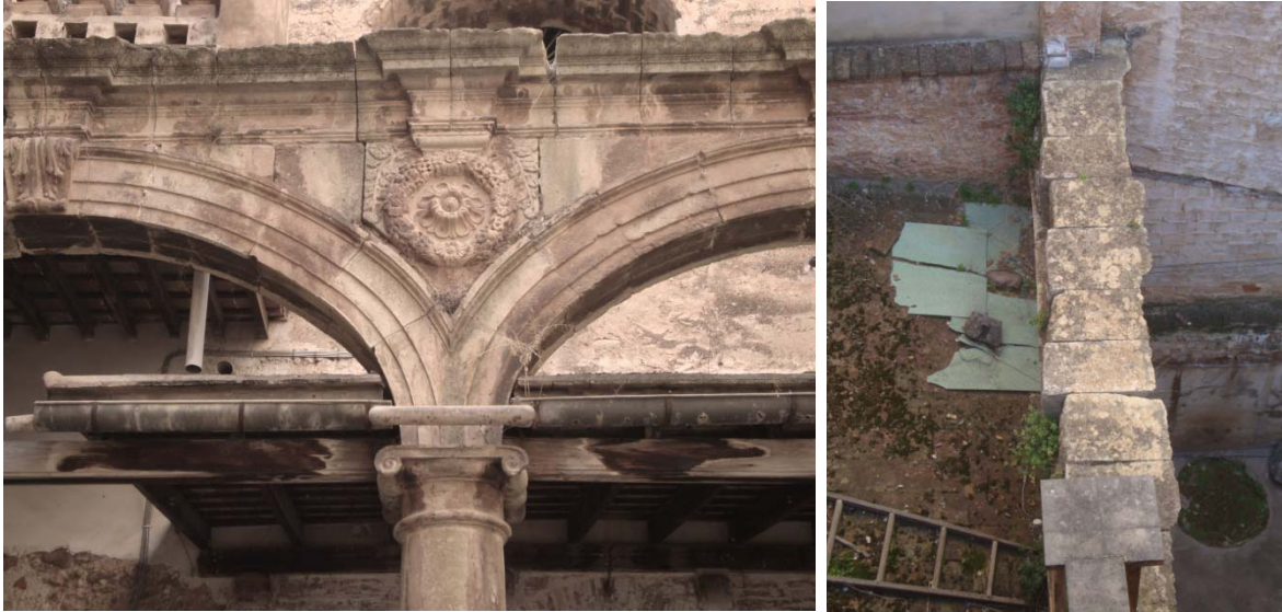
Sillares del entablamento de la panda oeste del claustro en peligro de caída
