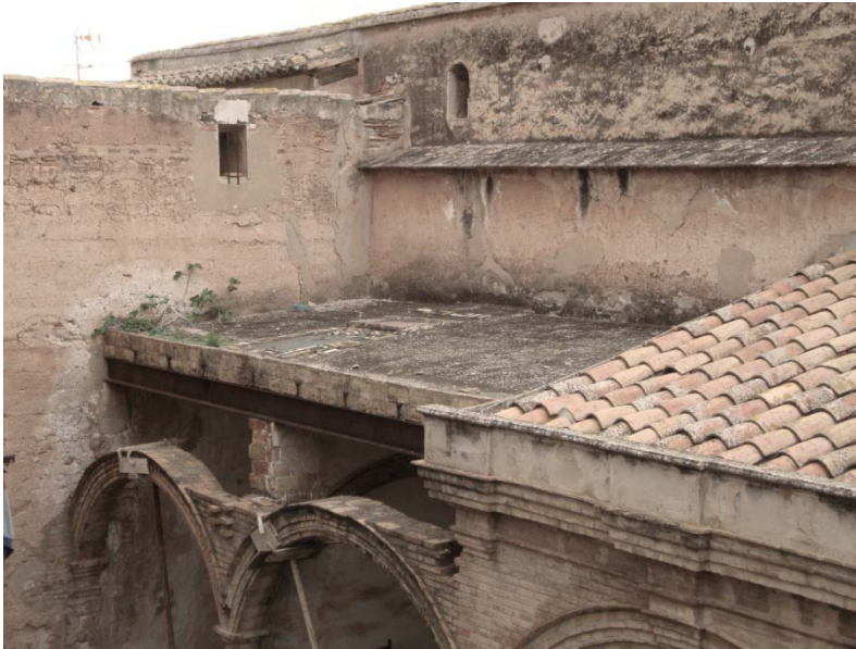
Cubiertas del edificio en aceptable estado de conservación, exceptuando los dos últimos tramos de la izquierda de la fotografía
